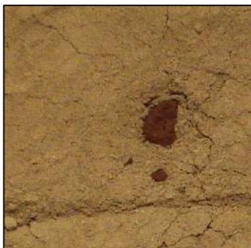
Figura 48. Manchas de tipo goteo sobre superficie terrosa.
