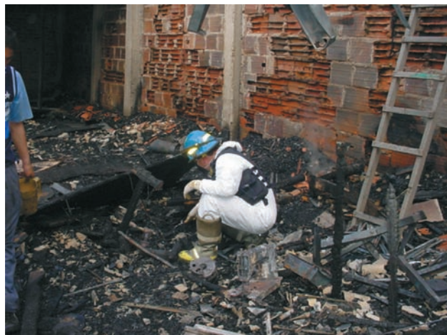
Determinación de origen y causa del incendio.
