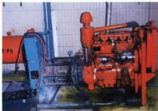
G. Puntos de salida de la red con drenaje en el motor y de la red eléctrica
