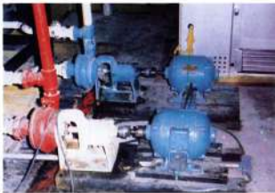
F. Sistema de bombeo imagen
