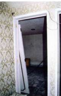
C. Entrada a una habitación donde se almacena una de las puertas desprendida en su origen.
