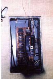
D. Tablero general con descubi- cubrimiento superior a su capacidad, mostrando dentro del fornix y ahumamiento en la parte superior.
