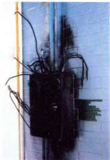
E. Tablero eléctrico quemado.
