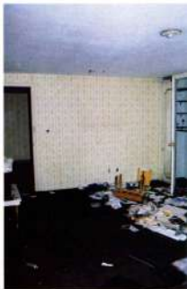
E. Dentro de la habitación se observa gran cantidad de objetos diversos en desorden y suciedad casi total de habitación
