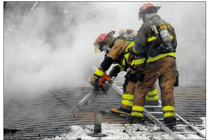
Imagen 108. Ventilación natural en cubierta
