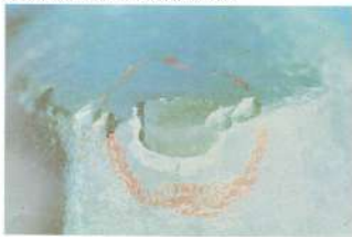
Fig. 6.38. Acercamiento del sitio del desprendimiento.
