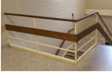
Non Compliant stairs
