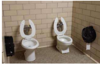
Non compliant toilets
