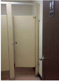
Non compliant toilet
