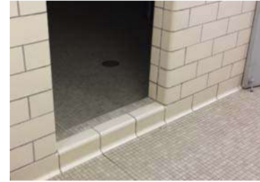
Non compliant showers
